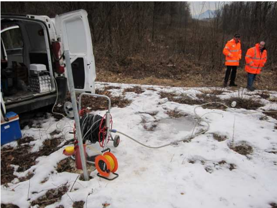
FOTO 2 Vista da sud del piezometro.
