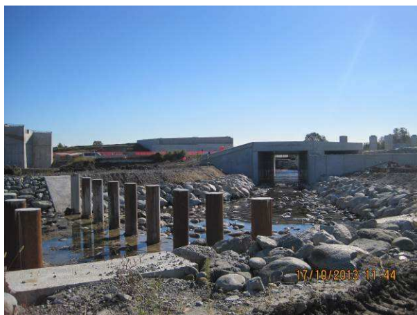
Foto 2: FIM-SE-03 - vista verso valle: attività relative alla risistemazione idraulica del fiume Seveso
